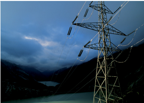
Elektrische Energie der Kraftwerke Oberhasli AG (KWO) trägt wesentlich zur Versorgungssicherheit der Stadt Bern bei. (Foto: R. Bösch)
