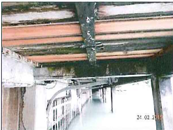
Foto 437: Stegkonstruktion, Betonbauteile Querträger mit Abplatzungen (Zwängungen?)
