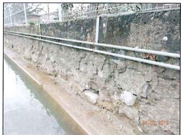
Detail Ansicht: Mauerwerk mit lokalen Ausbrüchen.
