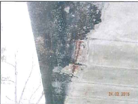
Foto 586: Bogenbrücke Abplatzung mit sichtbar korrodierter Bewehrung an der Untersicht infolge ungenügender Bewehrungsüberdeckung und fehlender Wassernasse..
