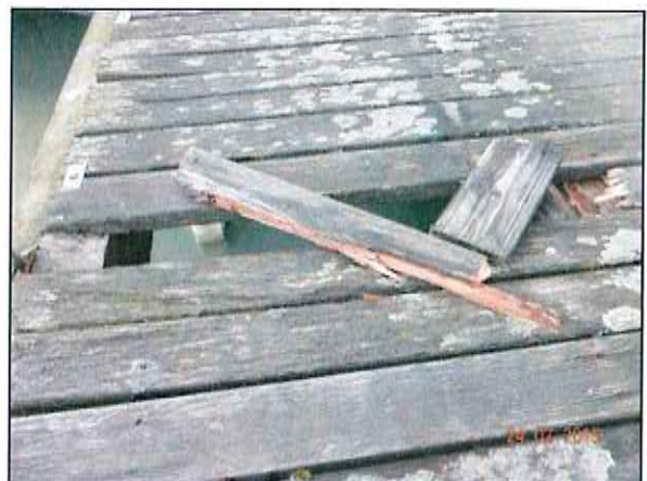
Bereich mit gebrochenen und morschen Brettern. Hier besteht Einsturzgefahr.
