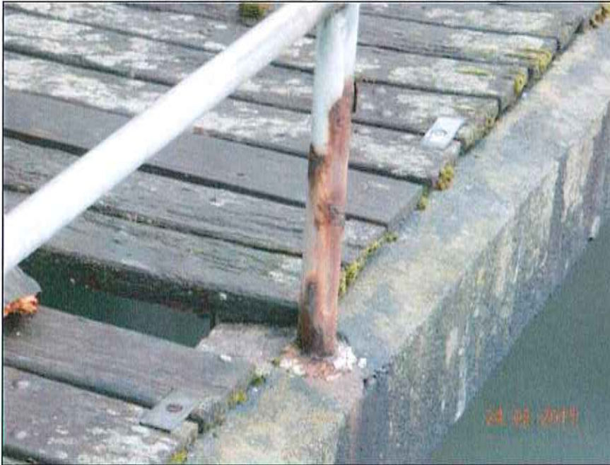
Foto 376: Stegkonstruktion, Geländer Geländerpfosten mit starker Korrosion und Lochfrass.
