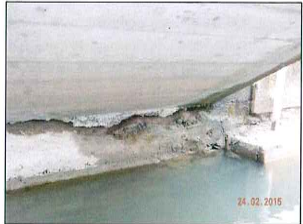
WL Seite Stadt: Horizontaler Riss bzw. Hohlraum auf die Gesamte breite, Höhe bis 8 cm.
