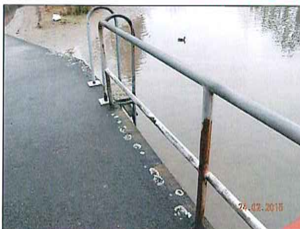
Detailansicht Geländer mit starker Korrosion
