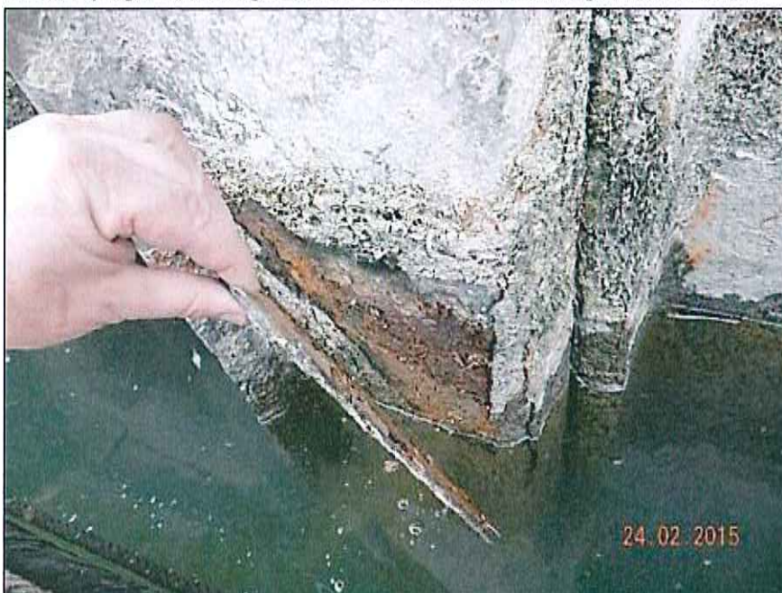
Foto 648: Abschlusswand, Spundwand: Starke Korrosion mit Rostkrusten von 3-4 mm in der Wasserwechselzone (hier auf der Aussenseite)
