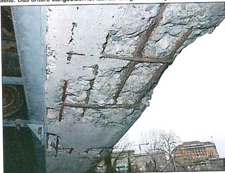
Foto 464: Abschlusswand, Betonkonstruktion: Grosse Schadstelle mit sichtbar korrodierter Bewehrung an der Untersicht Betonbalken bei Tor.
