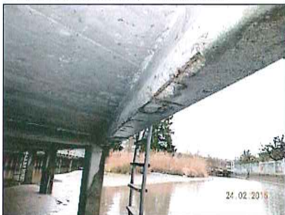
Foto 405: Stegkonstruktion, Betonbauteile Längsträger mit viele Abplatzungen
