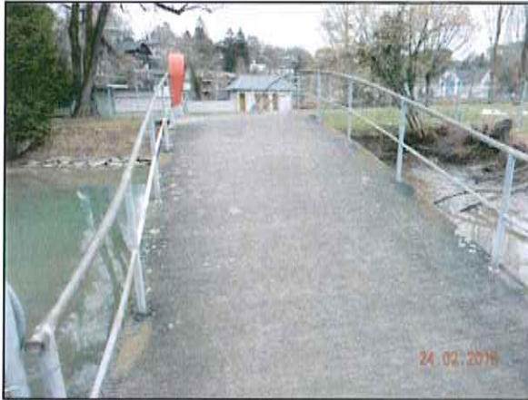
Übersicht Bogenbrücke. Geländer mit leichten Korrosionserscheinungen.
