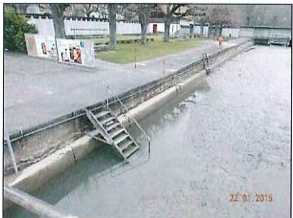
Foto 217: Stützmauer Übersicht Stützmauer mit Betonverstrebung im Fussbereich und den maroden Ausstiegleitern.
