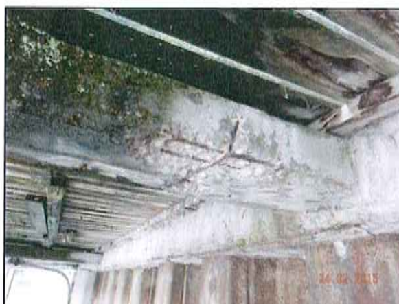
Querträger Steg, Balken Spundwand 2015: Die massive Zunahme der Schadstellen und der Korrosion der Bewehrung ist deutlich zu erkennen.
