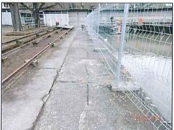
Foto 585: Stützmauer Setzungen hinter der Mauer (Unterspülung Fundament). Unklar wann diese entstanden sind.
