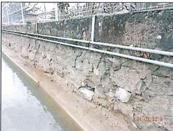
Foto 531: Stützmauer Viele lokale Ausbrüche beim Mauerwerk und Abplatzungen im Mörtelverputz / Fugenmörtel
