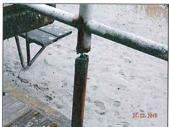
Geländerpfosten komplett durchgerostet.
