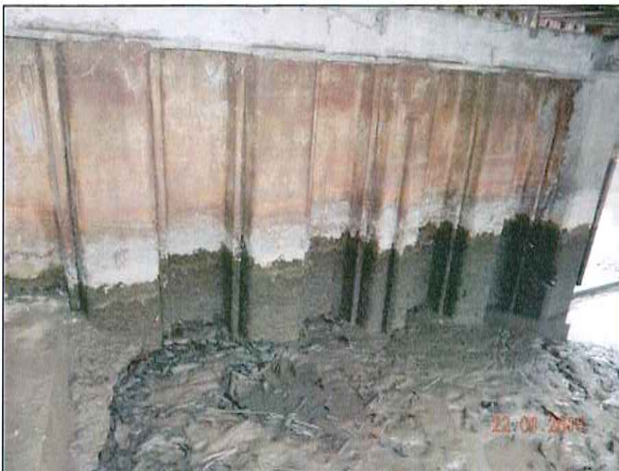
Foto 227: Abschlusswand, Spundwand: Starke Korrosion mit Rostkrusten von 2-4 mm in der Wasserwechselzone und Unterwasser. Über dem Wasserspiegel vollflächige leichte Korrosionserscheinungen festzustellen.
