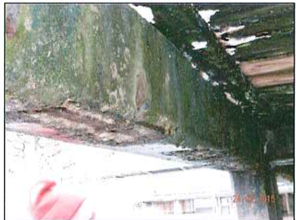
Längsträger mit grossflächigen Abplatzungen mit sichtbar korrodierter Bewehrung an der Untersicht.
