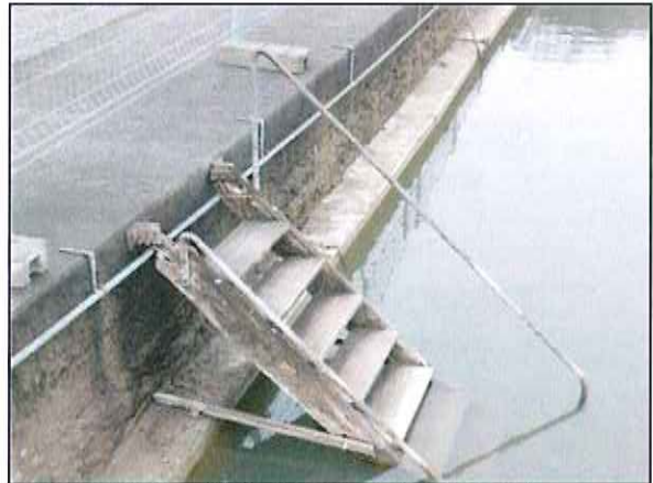
Ausstiegsleiter: Holz in marodem Zustand.
