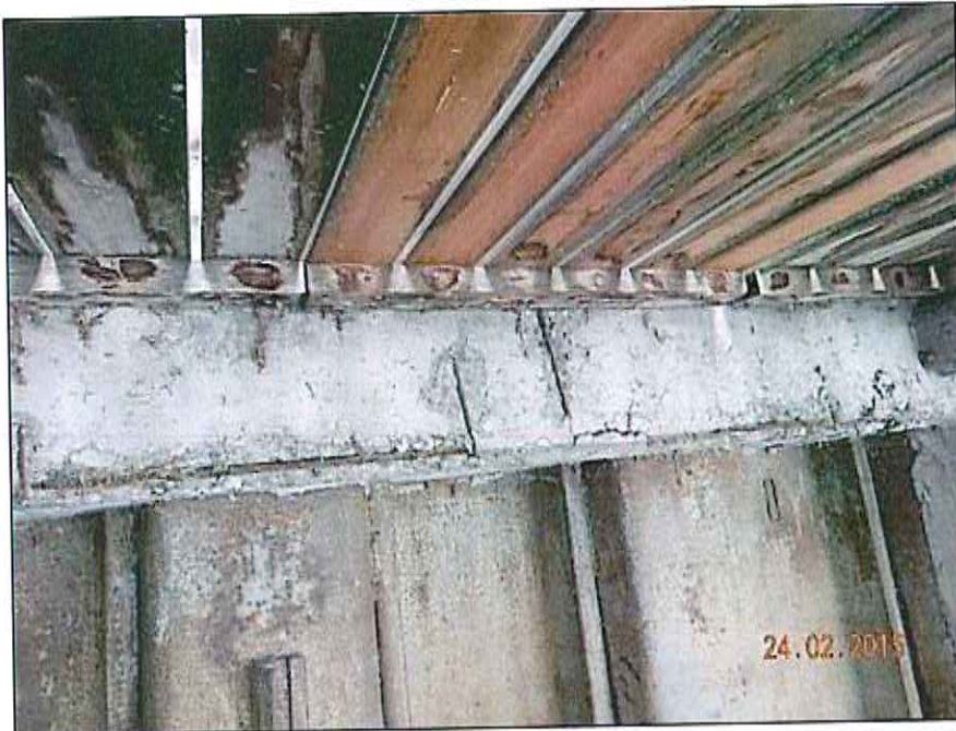
Foto 420: Abschlusswand, Betonkonstruktion Sehr viele Abplatzungen mit sichtbar korrodierter Bewehrung und Hohlstellen beim Betonbalken Innenseite. Das untere Längsisen ist fast auf die gesamte Länge sichtbar
