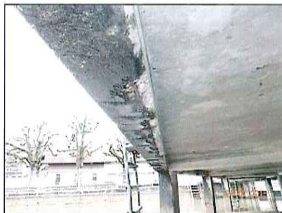
Foto 425: Stegkonstruktion, Betonbauteile Längsträger mit vielen Abplatzungen.
