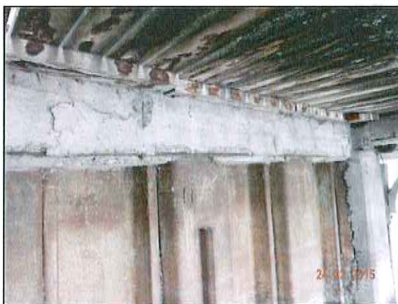
Betonbalken mit Abplatzungen an der Unterkante infolge korrodierter Bewehrung fast auf die gesamte Länge.
