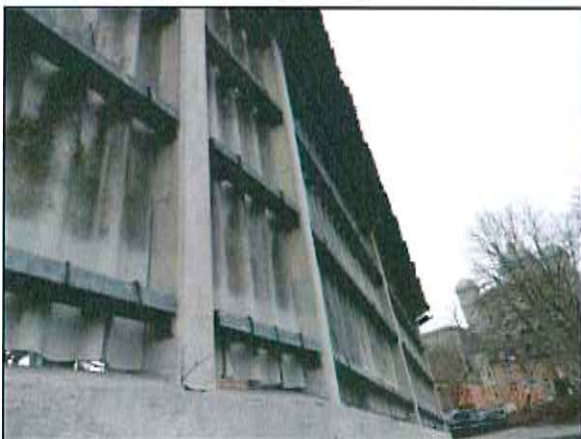
Foto 613: Stegkonstruktion, Überdachung Überdachung auf der Aussenseite. Die Verzinkung der Stahlprofile leicht abgewittert. Lokale Schadstellen bei Betonjochen.
