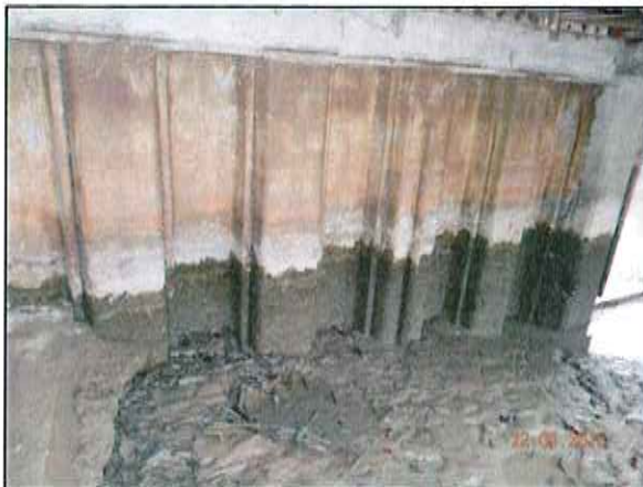
Ansicht Seite Bueberseeli: Starke Korrosion mit abgelösten Eisenoxidschichten im Unterwasserbereich und der Wasserwechselzone
