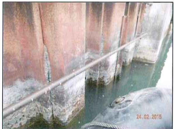
Ansicht Seite Aare: Starke Korrosion mit abgelösten Eisenoxidschichten in der Wasserwechselzone.
