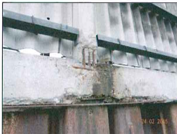
Foto 625: Stegkonstruktion, Überdachung Abplatzung mit sichtbar korrodierte Bewehrung im Fussbereich Betonjoch.
