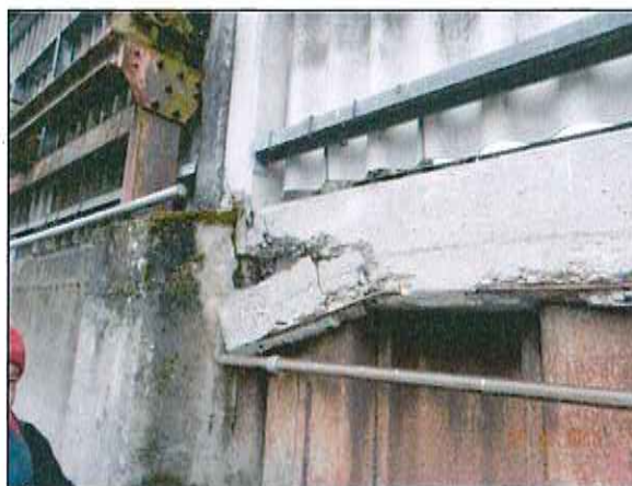
Aussenseite: Grössere Abplatzung mit sichtbar korrodierter Bewehrung.
