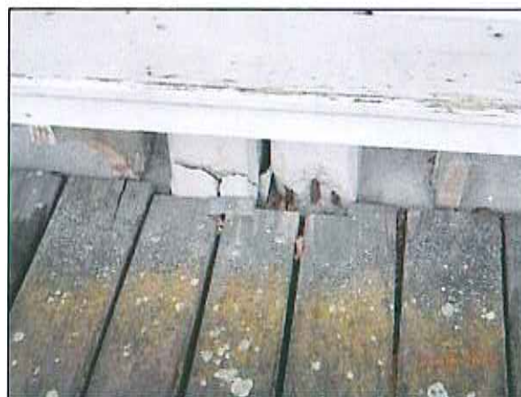
Foto 363: Stegkonstruktion, Überdachung Betonjoche mit Abplatzungen und sichtbar korrodierte Bewehrung.
