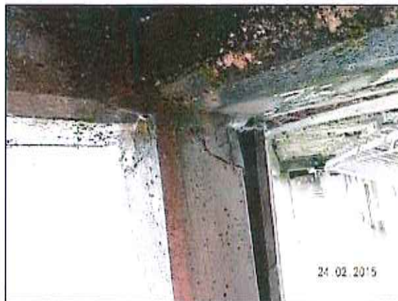
Foto 396: Stegkonstruktion, Betonbauteile Abplatzung bei Stütze (Zwängungen?)
