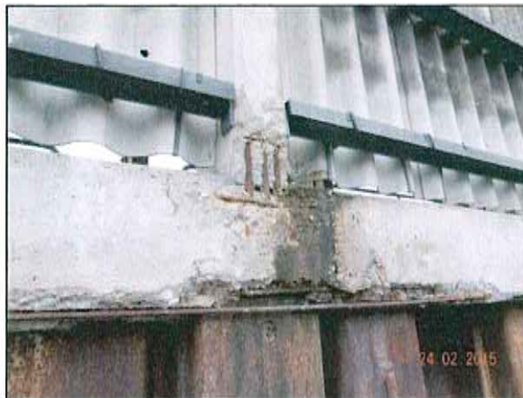
Abplatzung mit sichtbar korrodierter Bewehrung im Stützenfussbereich Aussen
