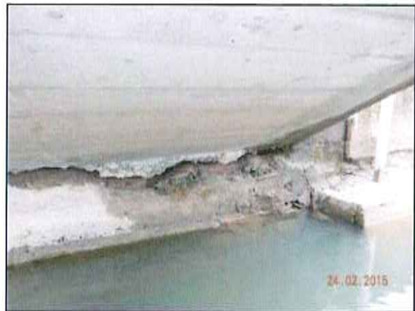
Foto 585: Bogenbrücke WL Seite Stadt: Grosser Riss mit Hohlraum infolge Setzungen bei der Stützmauer.
