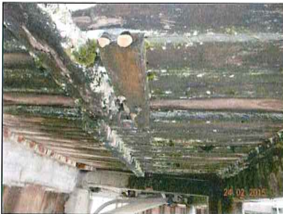
Untersicht Holzkonstruktion mit starker Durchfeuchtung, morschen Bereichen und Pilzbefall
