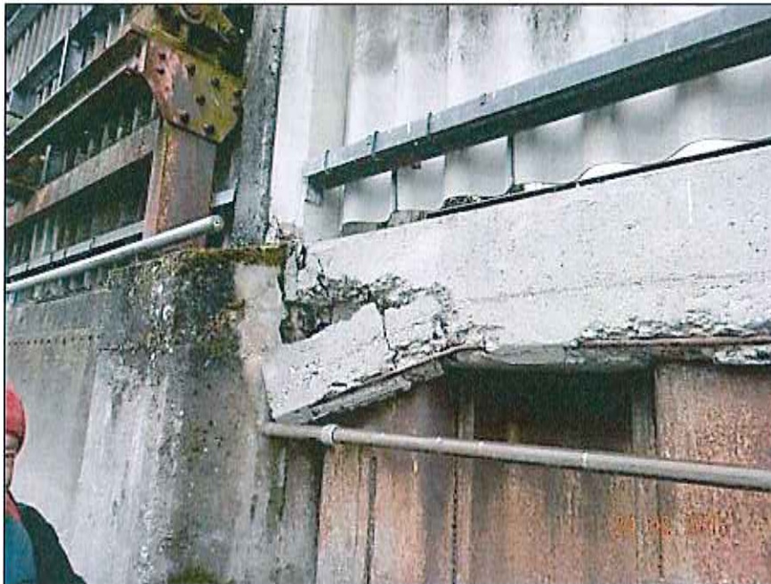
Foto 647: Abschlusswand, Betonkonstruktion: Grosse Schadstelle mit sichtbar korrodierter Bewehrung beim Betonbalken
