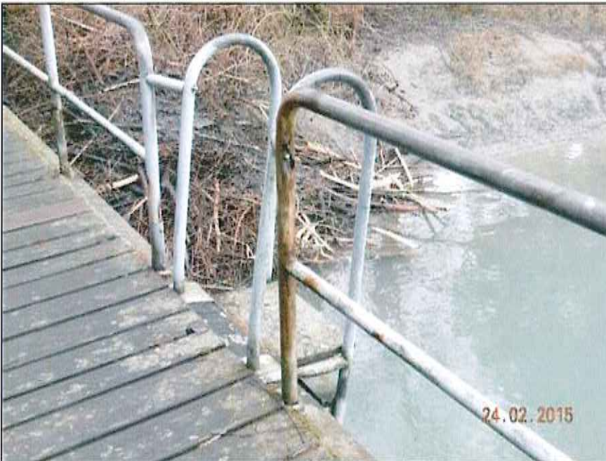
Foto 394: Stegkonstruktion, Geländer Starke Korrosion mit Lochfrass bei Geländerpfosten. Die Ausstiegsleiter sind zusätzlich an den Pfosten verankert.
