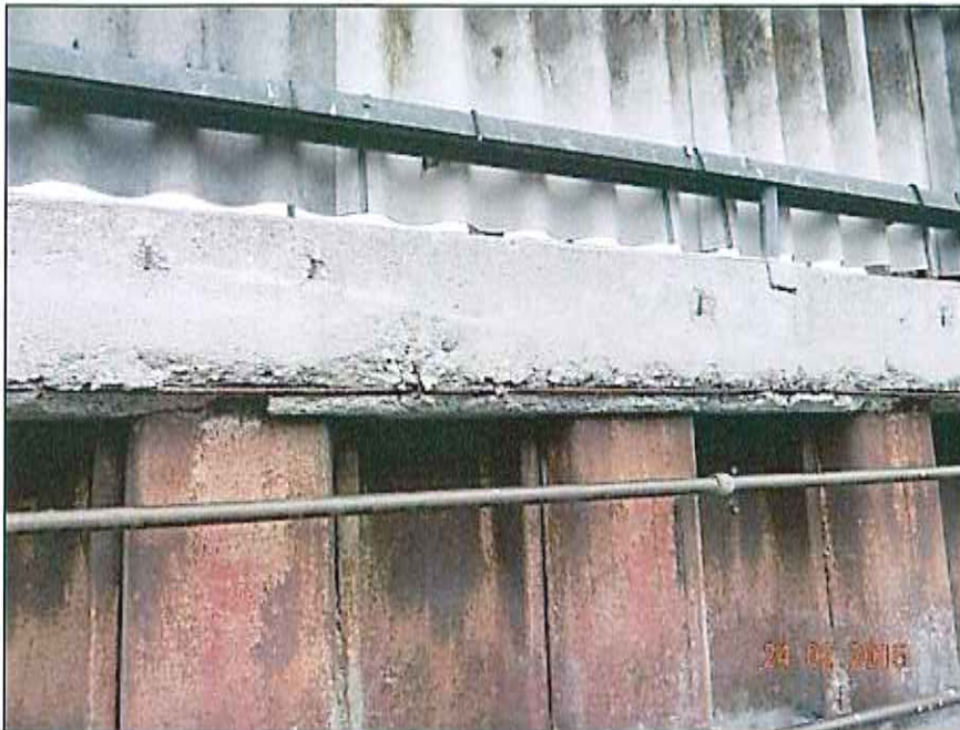
Foto 640: Abschlusswand, Betonkonstruktion: Grosse Schadstelle mit sichtbar korrodierter Bewehrung beim Betonbalken
