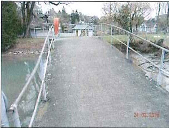
Foto 531: Bogenbrücke Übersicht Bogenbrücke. Oberfläche teilweise stark ausgewaschen. Geländer mit leichten Korrosionserscheinungen.
