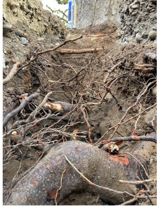
Starke Durchwurzelung unmittelbar unter dem eingebauten Wandkies
