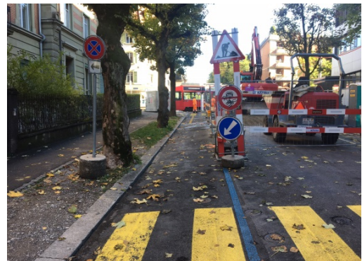
Trotz grossen Baumassnahmen wird die Durchfahrt für den Veloverkehr ermöglicht. Am Rand der Baustelle konnte eine schmale Durchfahrt für den Veloverkehr offengehalten werden. Damit werden neben der Durchgängigkeit für den Veloverkehr auch Konflikte mit dem Fussverkehr auf dem Trottoir vermieden (Spitalackerstrasse).
