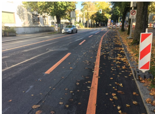
Gute und klare Veloführung vor der Querschnittsverengung. Im anschliessenden Bereich der Baustelle konnte trotz engem Querschnitt ein temporärer Radstreifen markiert werden (Viktoriastrasse).
