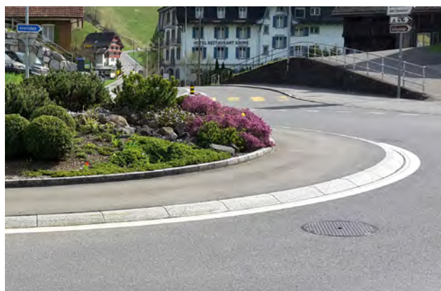
Der aufgeschiftete Innenring ist ein wichtiges Ausführungsdetail. Damit werden ein genügender Ablenkwinkel und in Folge dessen tiefe Geschwindigkeiten des motorisierten Verkehrs sichergestellt. (Bild: Jonas Zurschmiede).
