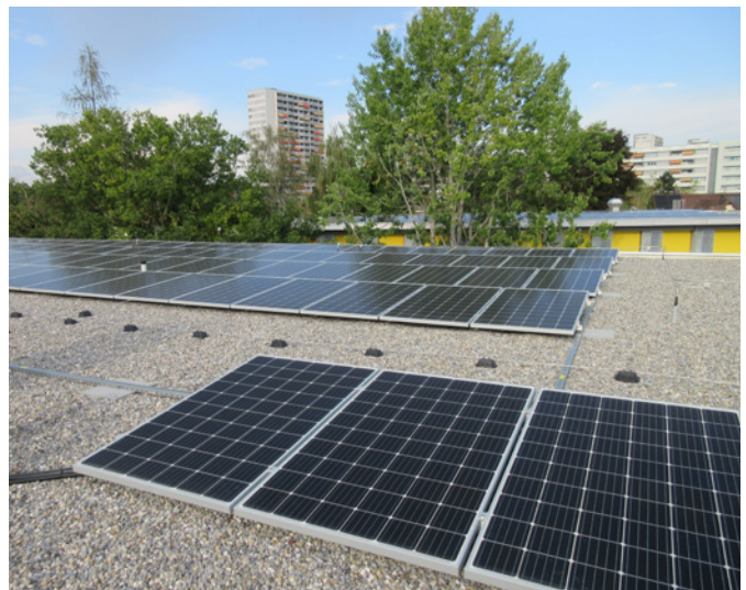
Photovoltaikanlagen auf den Dächern der Modulbauten
