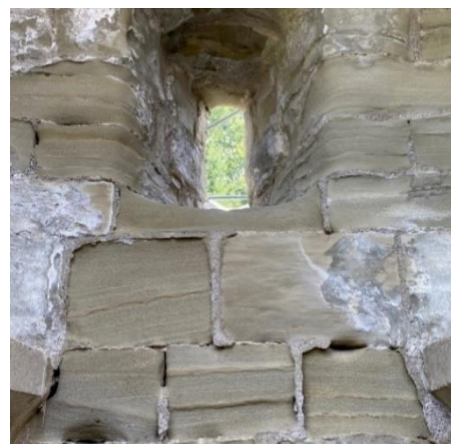
Starke Verwitterungsschäden bei den Fensternischen
