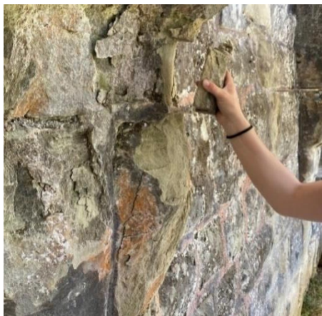
Durch Verwitterung loses Mauerwerk am Kamin
