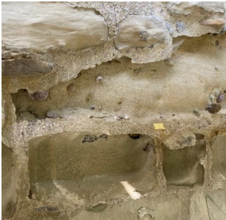
Starke Verwitterung des Sandsteins, die harten Betonfugen bleiben stehen.
