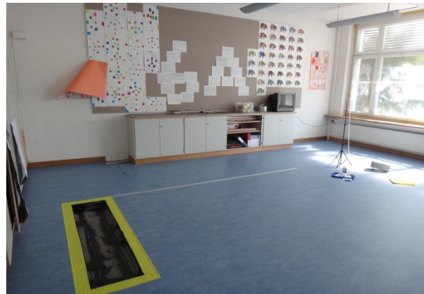
Abb. 4: Zimmer 3/003, Raumluftmessung nach Abdichten des aufgebrochenen Bodenaufbaus
