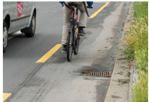
Problematisch: Der Einlauf nimmt vom schmalen Radstreifen eine erheblich Breite weg; der Deckbelag ist zudem beschädigt. Dies führt zu Ausweichverhalten und zu Sturzgefahr.
