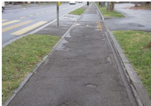
Stark beschädigter Deckbelag auf dem Radweg entlang der Winkelriedstrasse vor dem Umbau. Velofahrende haben den Radweg teilweise gemieden und sind auf der Strasse gefahren.
