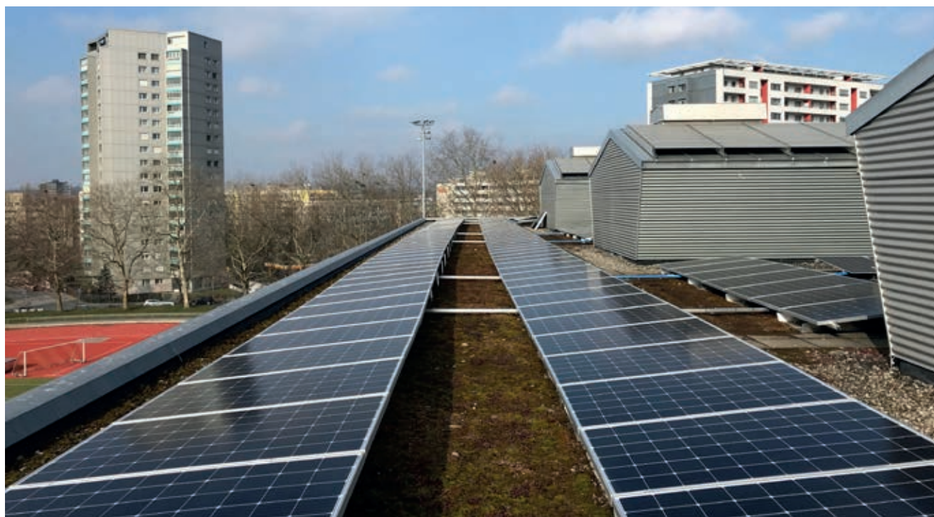
Photovoltaikanlage Solarify GmbH – SP Wankdorf, Papiermühlestrasse 91
