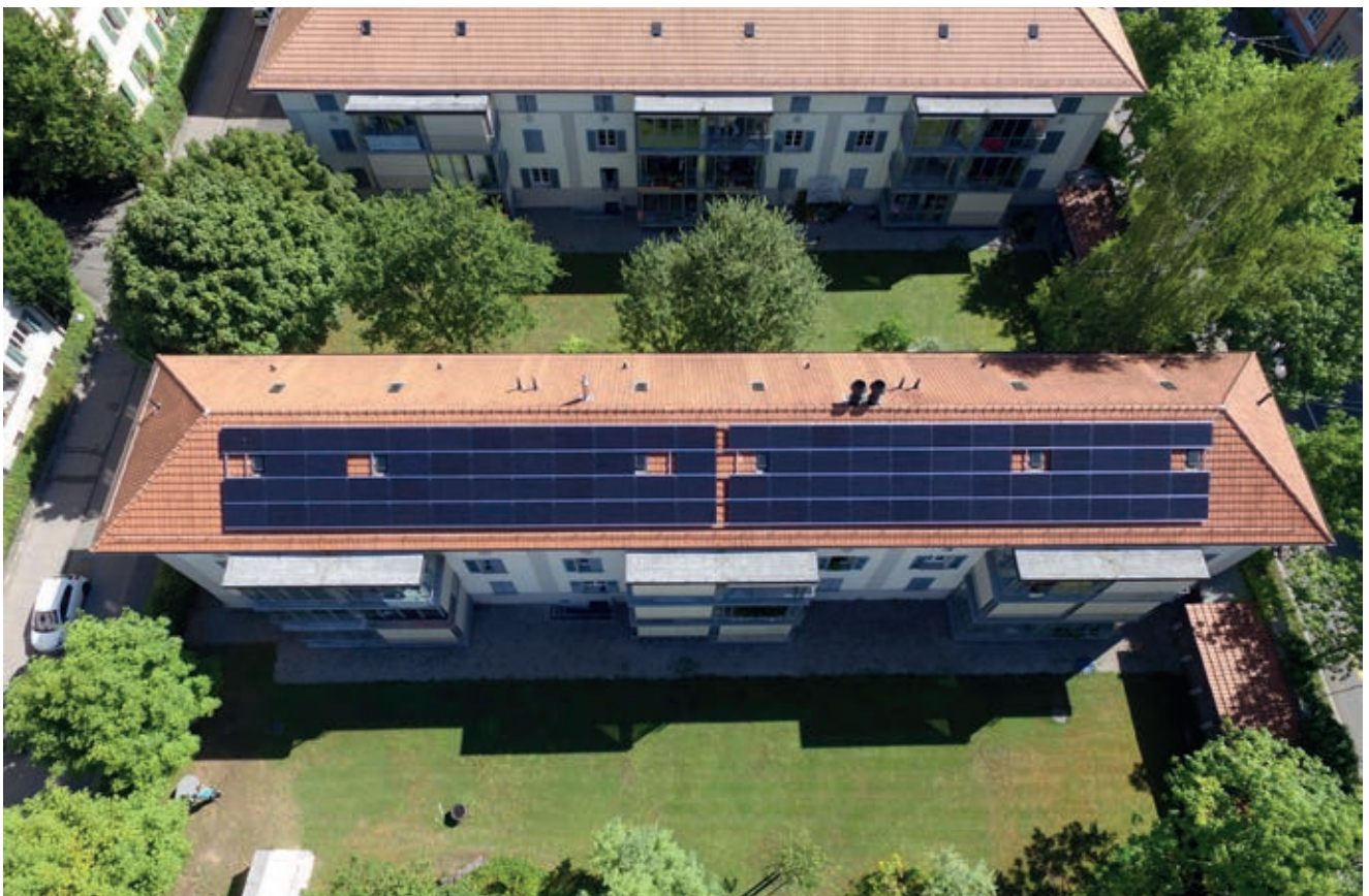
Photovoltaikanlage Verein Sunraising – Mehrfamilienhaus Standstrasse 24, 26, Wylerfeldstrasse 35
