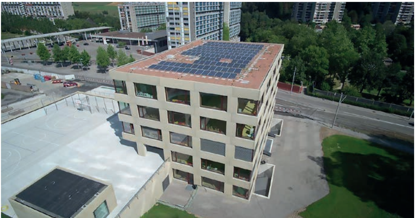
Photovoltaikanlage ewb – VS Brünen, Billeweg 5
