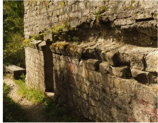
Heutiger Zustand schadhafter Mauersockel
