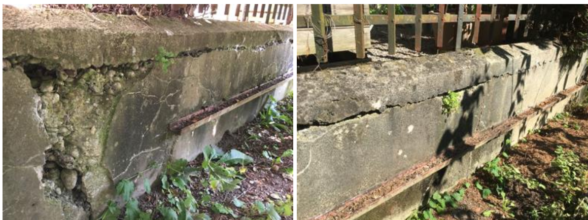
Abb. 10 und 11: Schadensbild Einfriedungsmauer
