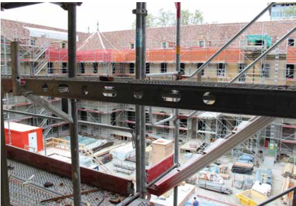
Blick auf die aktuelle Baustelle beim zukünftigen Berner GenerationenHaus im Burgerspital (Foto: Burgergemeinde Bern)
