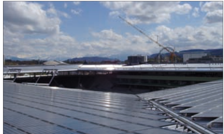
Der ökologische Umbau hat begonnen: Solaranlage auf dem Stade de Suisse.
