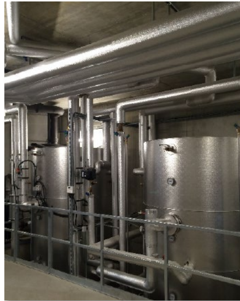
Energie- und Warmwasserspeicher
