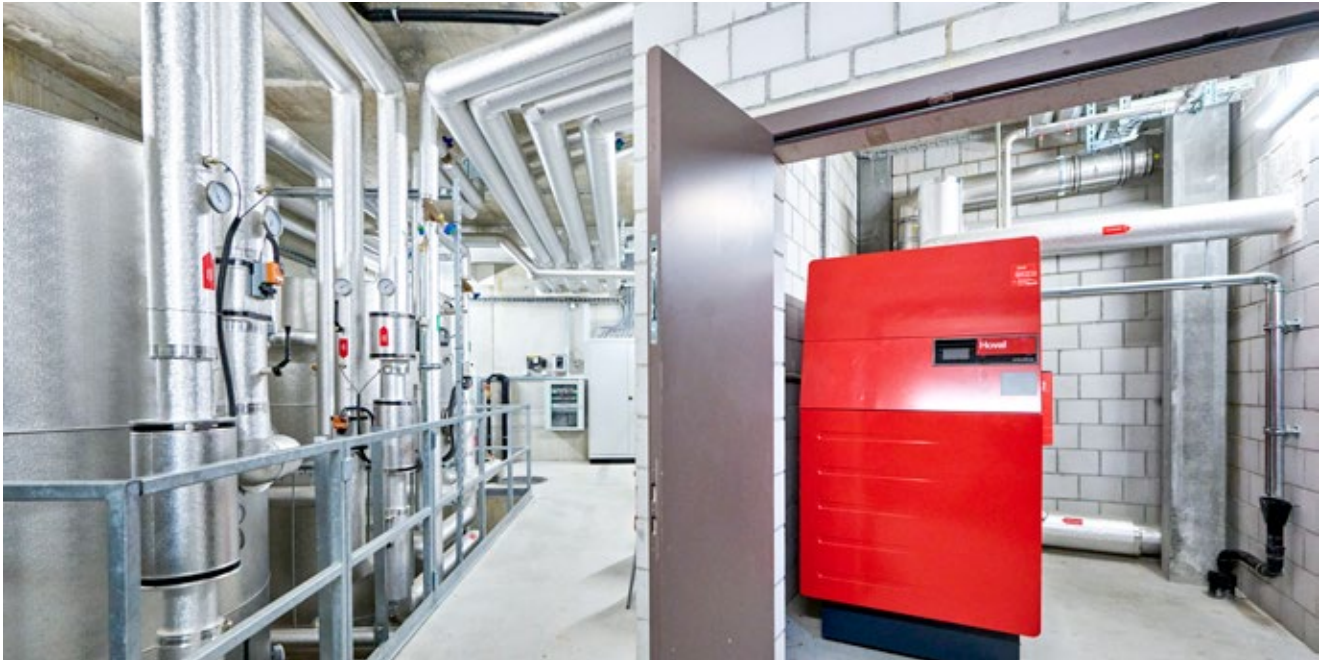
Aufbereitung Warmwasser: In der Siedlung Stöckacker Süd wird das Warmwasser ergänzend mit Biogas aufbereitet.
