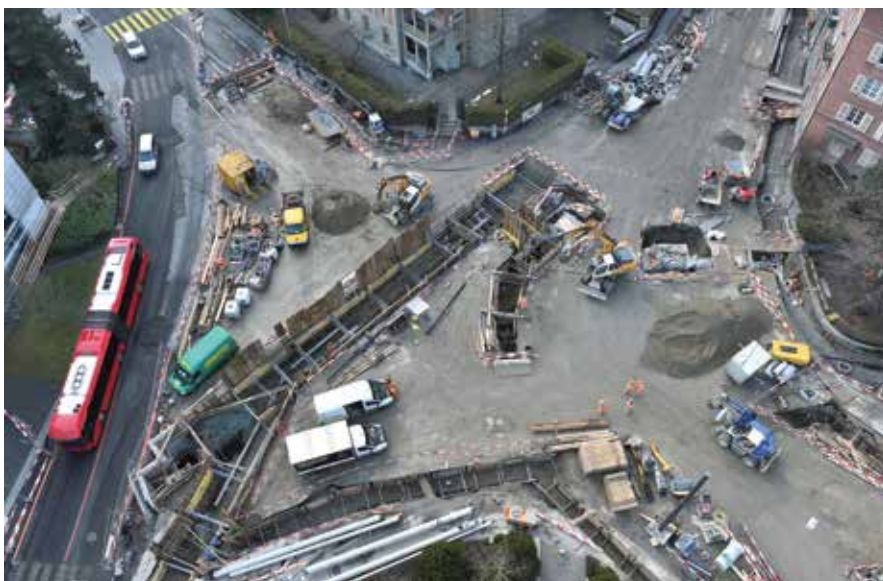
Regelrecht umgepflügt: Die Arbeiten zur Neugestaltung und Sanierung des Eigerplatzes dauern anderthalb Jahre.
