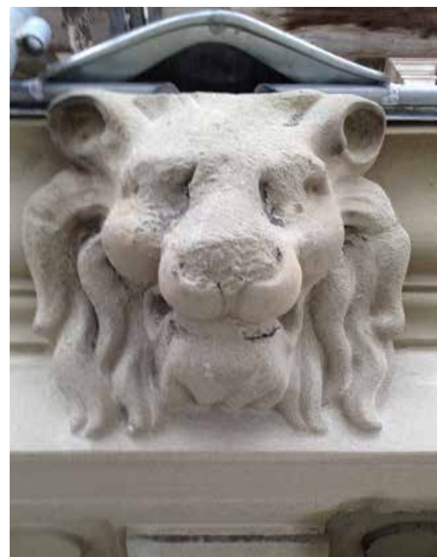
Löwenkopf vor Sanierung
