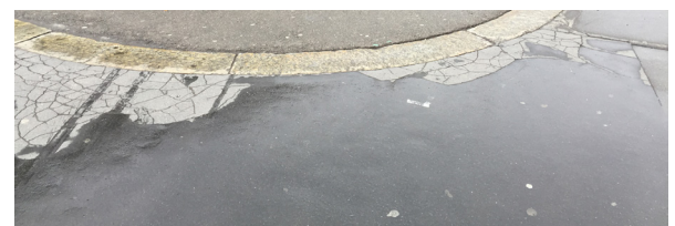
Pflasterung ist lärmig, Asphalt abgenutzt
