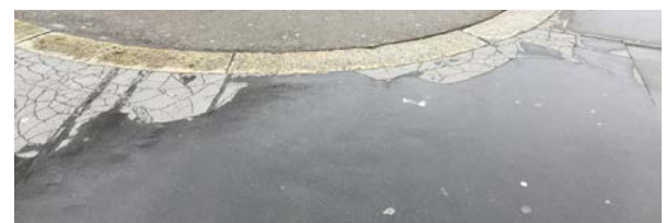
Pflasterung ist lärmig, Asphalt abgenutzt
