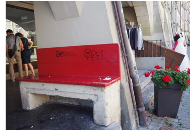
Bestehende Bänke oft abgenutzt
