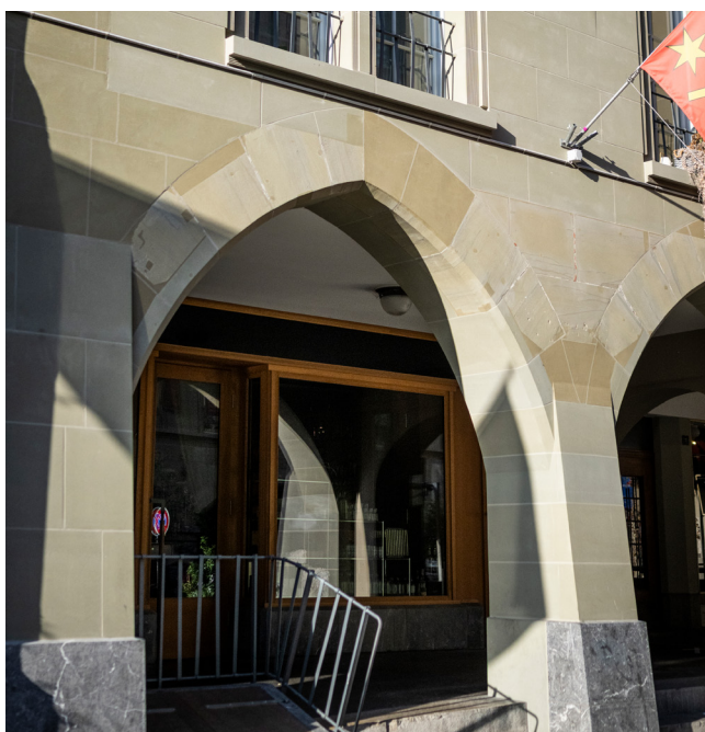
Abb. 01 – Rathausgasse 61, Bern. Eine lebendige Collage aus reparierten, ergänzten und aufgemörtelten Natursteinen. Foto: Simon Opladen
