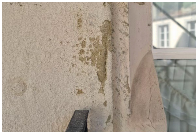
Abb. 03 – Detailaufnahme Fassade, Schollenbildung und Abplatzungen Foto: Fischer & Partner AG Restauratoren
