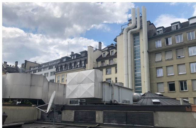
Abb. 01 – Innenhofsituation Bankgässchen. Terrassen werden zur Aufnahme von Lüftungs- und Klima-/Kälteanlagen benötigt.
