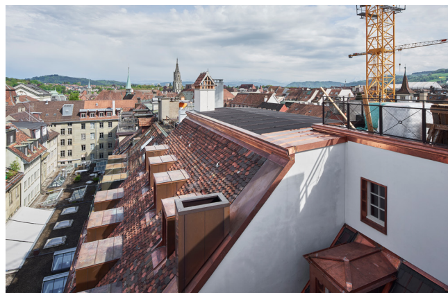
Abb. 02 – Die grossen Haustechnikkomponenten sind im Gebäudevolumen integriert. Gesamtsanierung Hotel Metropole, Foto: ©Damian Poffet
