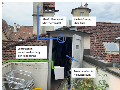
Abb. 04 – so nicht Theaterplatz 3, Bern: Die Darlegung der technischen Installationen ist nicht schematisch, sondern räumlich aufzuzeigen
