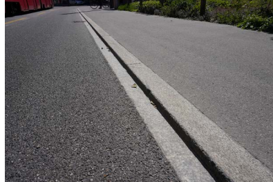
Randstein RN 15 (Anschluss Trottoir) 6cm Versatz mit Wasserplättli
