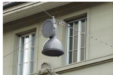
3. Überspannleuchte mit Seitenstrahler
