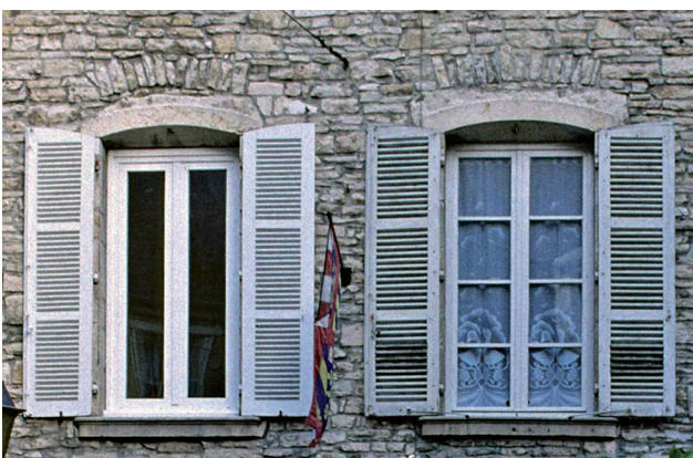
Ersatzfenster (links), das wegen fehlender Sprossen, zu breiter Flügelrahmen sowie falsch gewählter Materialisierung und Farbe die Qualität des Originals (rechts) in jeder Hinsicht verloren hat. Bild: NIKE Bulletin Nr. 5/2004.
