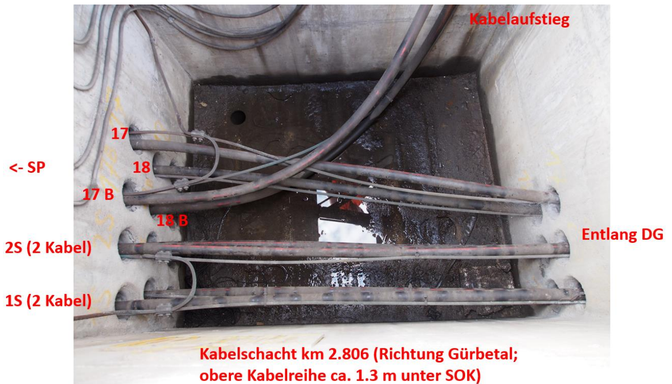
Abbildung 2-4: Anordnung der Kabel und der Rückleiter im Kabelschacht bei km 2.806, unmittelbar beim Kabelaufstieg der Speiseleitungen 17B und 18B.
