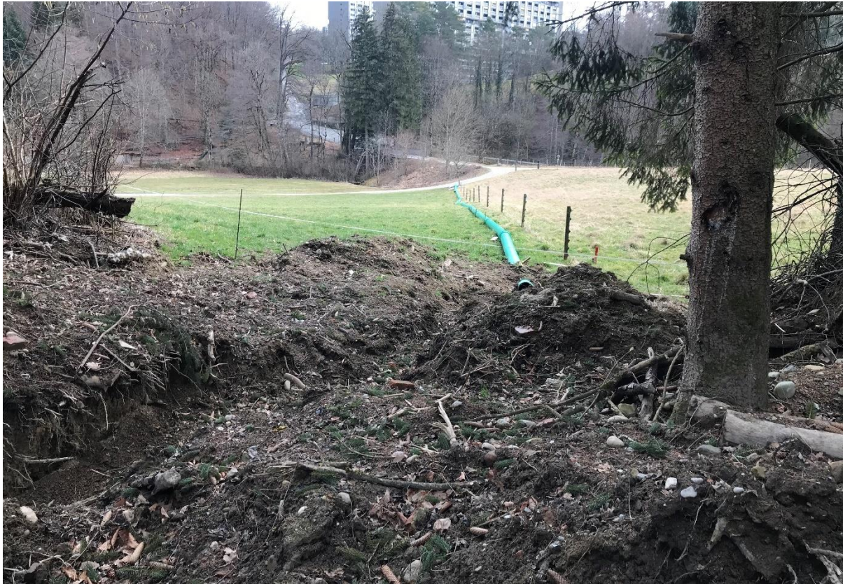
Bild 6: Provisorium Ableitung Überlast
