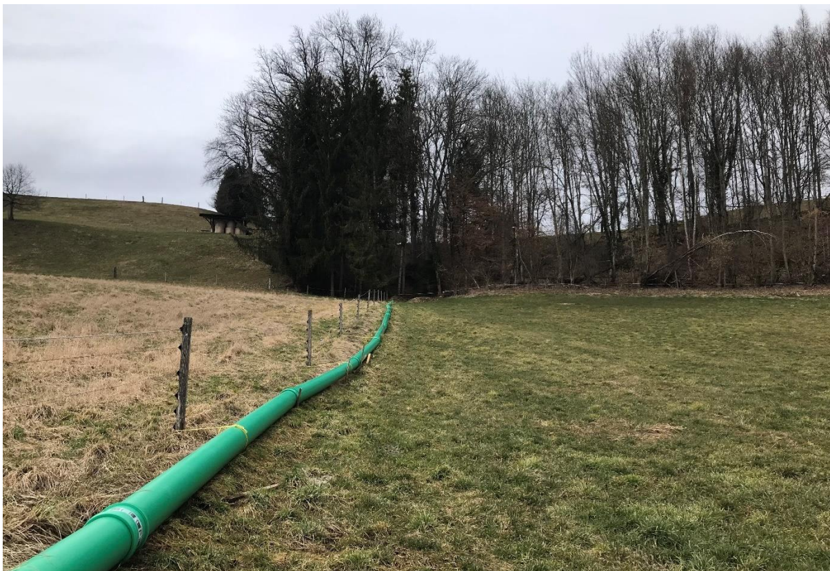
Bild 7: Provisorium Ableitung Überlast, Blickrichtung Obermatt
