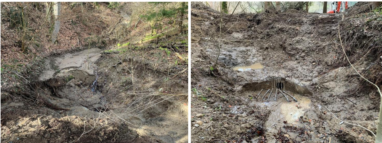
Abbildung 3.5 Ablagerungen vor Einlaufbauwerk
