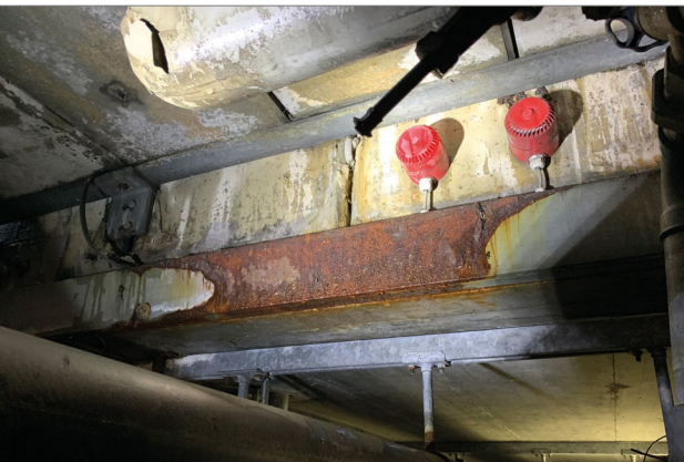
Die Badewassertechnik ist veraltet und entspricht nicht mehr den aktuellen Normen.
