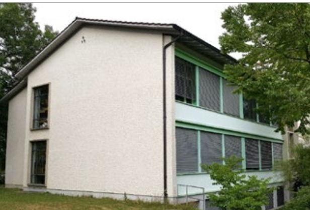
Die Schulanlage Bethlehemacker befindet sich in einem schlechten baulichen Zustand. Auf dem Bild ist der sanierungsbedürftige Pavillon am Kornweg 107 zu sehen.
